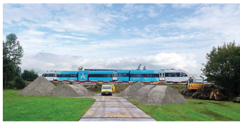
Reparatie bij het spoor ter hoogte van de verzakking. (foto: Hielke Boorsma).
