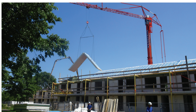
Op een enkele plek in het dorp wordt gebouwd. Op de nieuwbouw van Tjaskerhiem is afgelopen week het dak geplaatst. (foto: Hielke Boorsma)
