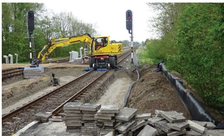
Verlenging van de perrons in Buitenpost om het station klaar te maken voor langere treinen. (foto: Hielke Boorsma)
