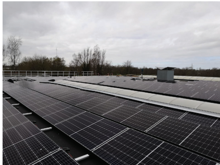
De zonnepanelen zijn geplaatst op het dak van Veenstra Reizen. (foto: Bouwe Veenstra)
