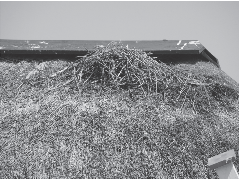
Het nest is hier duidelijk te zien. Onze ongevraagde bewoner brengt hierdoor wel schade toe aan de molen. Mogelijk kan hier lekkage door ontstaan. (foto's: Hielke Boorsma)
